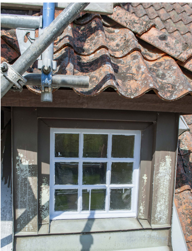
Den södra takkupan är inklädd med plåt. färgen flagnade på båda kuporna.
