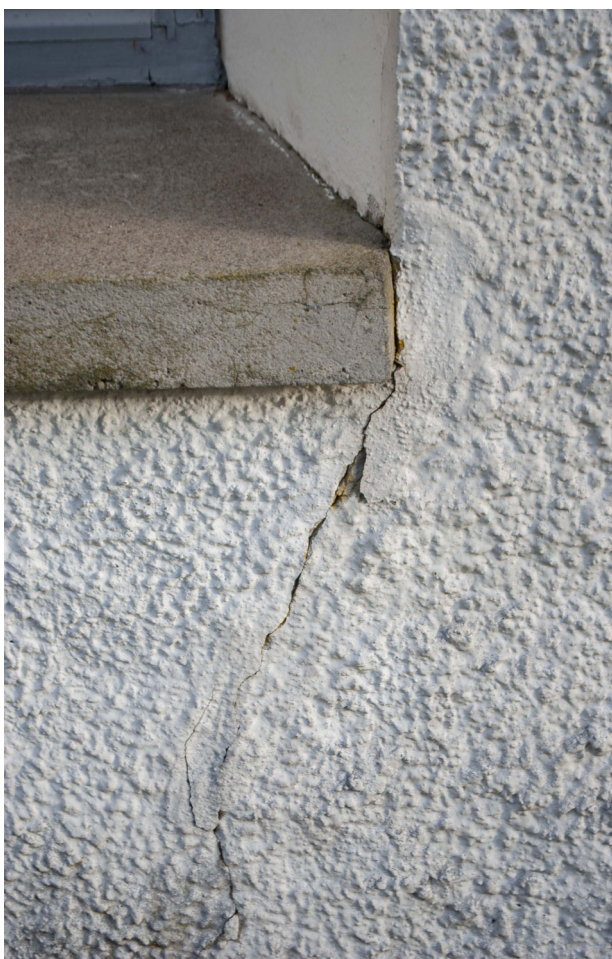
Sprickor fanns framför allt runt fönstren; här vid en solbänk mot söder.
