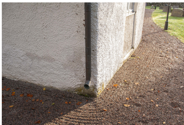
Putsskador längs marken på sakristian.
