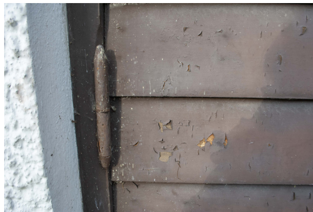
Dörren i öster in till koret är hårt utsatt för väder och vind och färgen flagnade betydligt.
