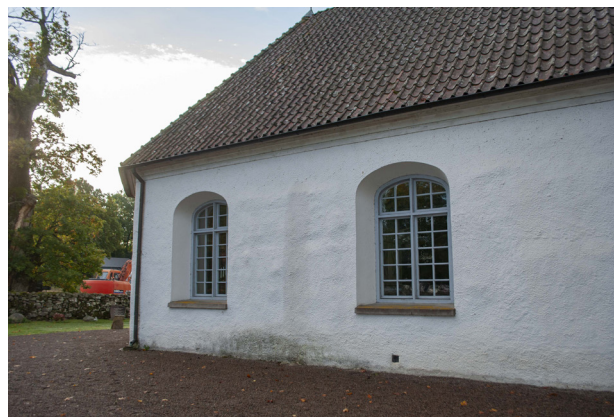
Kyrkans norra sida innan renoveringen. putsen är sliten och smutsig, framför allt längs marken.
