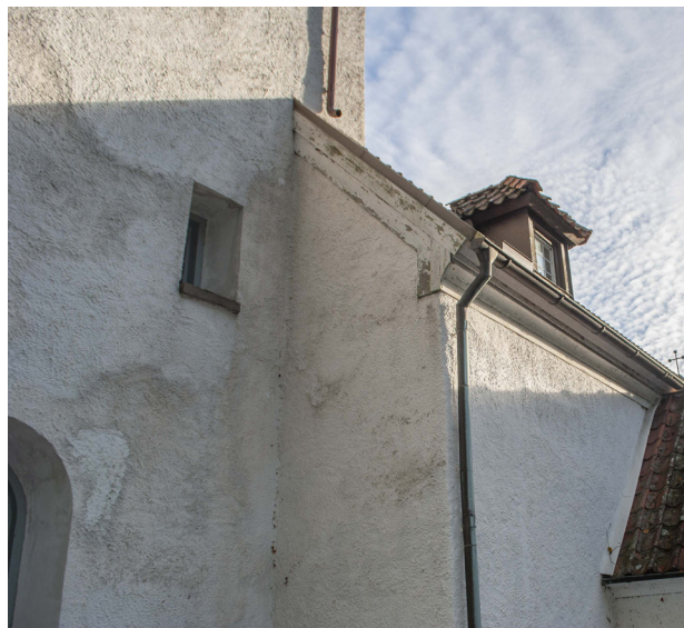
Putsen var flammig, smutsig och hade en del sprickor. Färgen på vindsxivorna flagnade.
