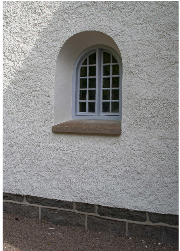
Nymålade puts och fönster i vapenhuset mot norr.
